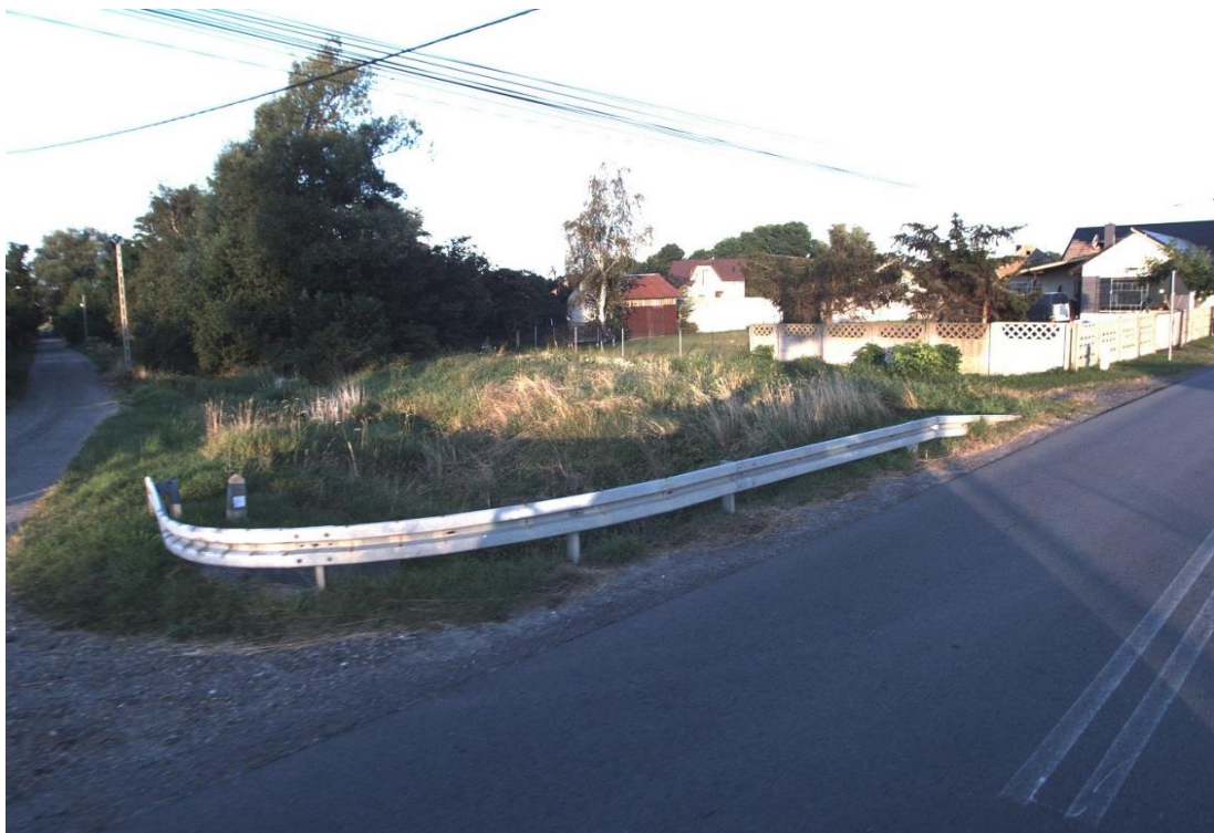
Zdj.54. Przedstawiające stan drogi powiatowej przed budową odwodnienia.
